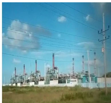
Grupos electrógenos de Güines. Foto: ICLEP
