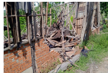
Casa de tabaco afectada: Foto ICLEP
