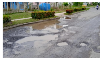
Baches en la Avenida a Viñales: Foto ICLEP
