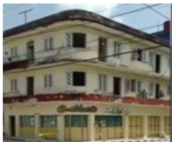
Edificio colapsado. Foto ICLEP
